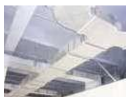
Air ducts Canalizzazioni
